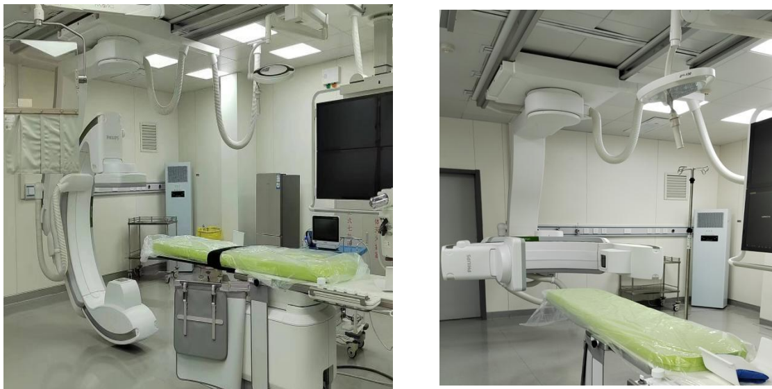
图 9-1 综合楼一楼急诊 DSA 有用线束不同方向的照射状态
